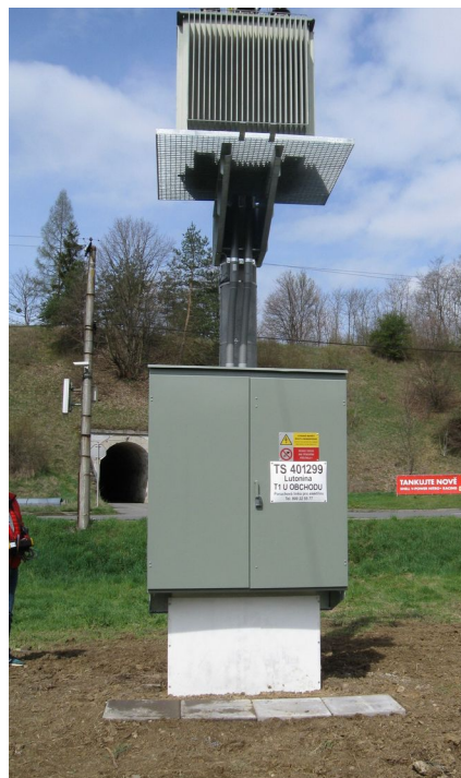
I z tohoto transformátoru s rozvaděčem, na kraji vesnice, se vložením chytré krabičky a připojením k internetu může stát uzel chytré sítě
